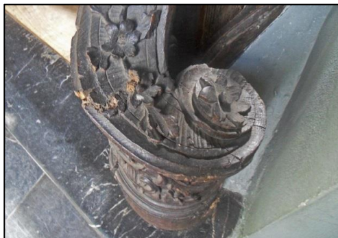
Een gesneden wrongstuk van een balustrade. Het herstel ervan kan worden beperkt tot Categorie 1 - Conserveren.
